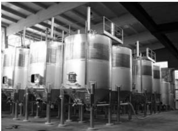
Depósitos autovaciantes de acero inoxidable con descube controlado regular.
