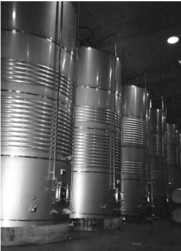
Depósitos de acero inoxidable sobre bancada de hormigón.
